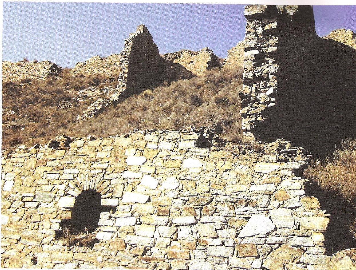
Foto 6.- Impresionante aspecto de la gran tolva de la trinchera Villalta. Se conserva una compuerta de carga con un artístico arco de medio punto
