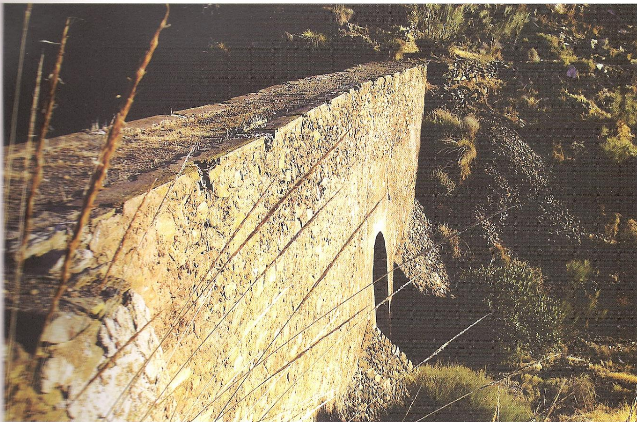
Foto 28.- Puente que cruza el Barranco de los Lobos desde el pozo Esperanza a Vía Vulcano. Es transitable
