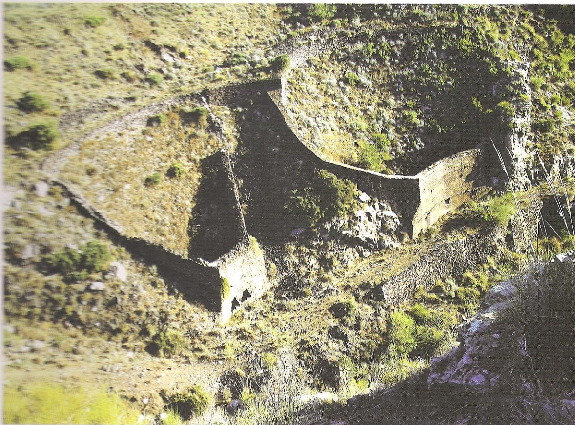
Foto 30.- Impresionante vista de las tolvas de Vulcano. Extraordinario ejemplo de arquitectura industrial que debe ser homologado y conservado
